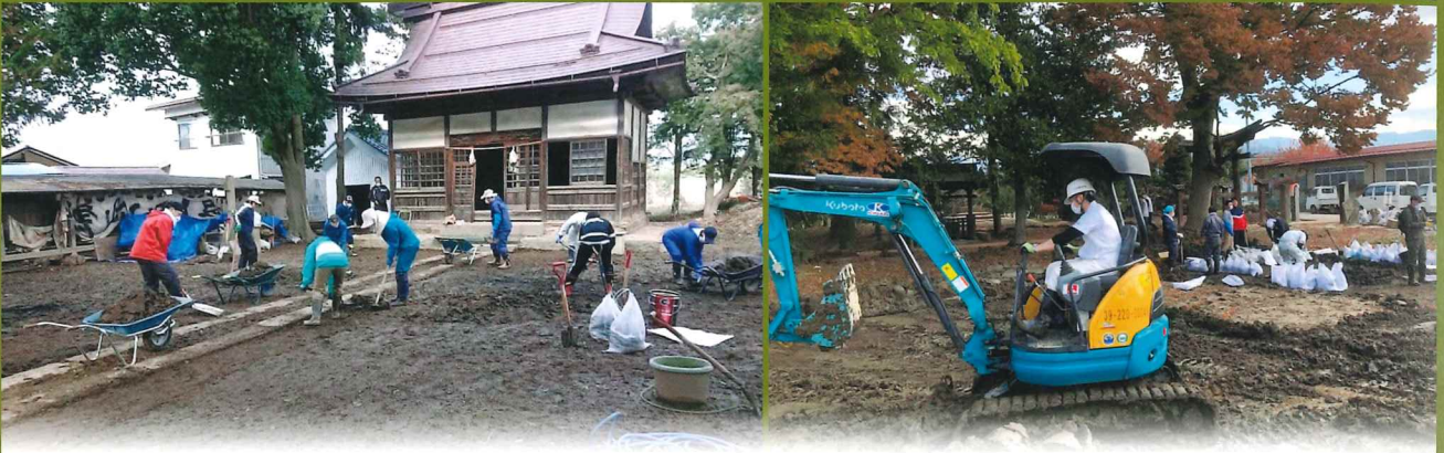
台風 19号による千曲川氾濫の被害を受けた流域 3社の復興支援に参加した。当会では災害対策として様々な準備を進めており(12~13頁参照)、重機や高圧洗浄機を駆使して迅速に作業を行うことができた。
